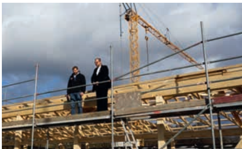
Im Vordergrund beim Richtspruch auf der Gerätehalle mit dem Chef der Zimmerei D. Kohl Herr H. Kohl und einem seiner Mitarbeiter.
